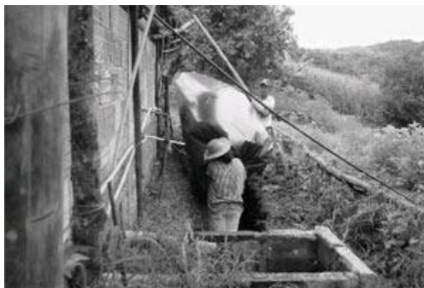
Construcción de un biodigestor agrícola en la década de los 1960. (Foto: Lylian Rodríguez. 1960)
