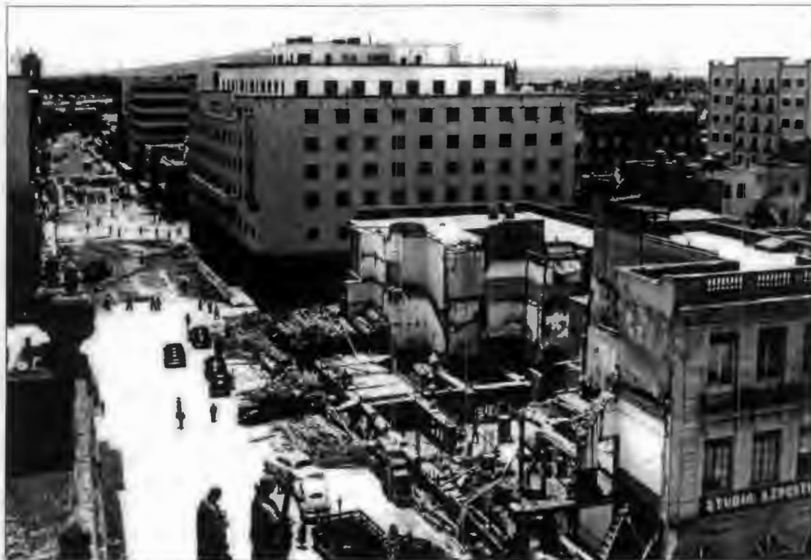
FIGURA 39. La destrucción de la manzana frente a la Plaza de Armas, vista desde la azotea del templo del Sagrario.
